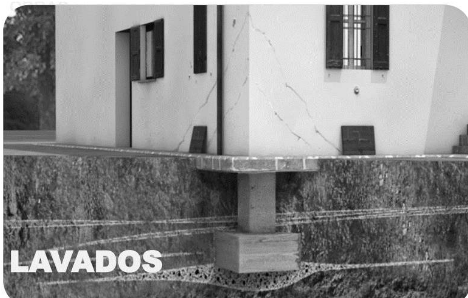
Grietas producidas por lavado de finos.
