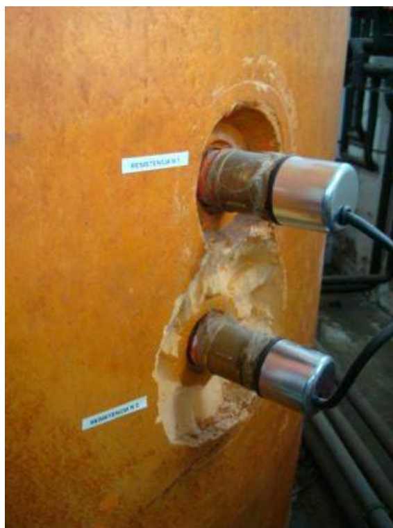
Figura 2.3: Detalle resistencias eléctricas.
