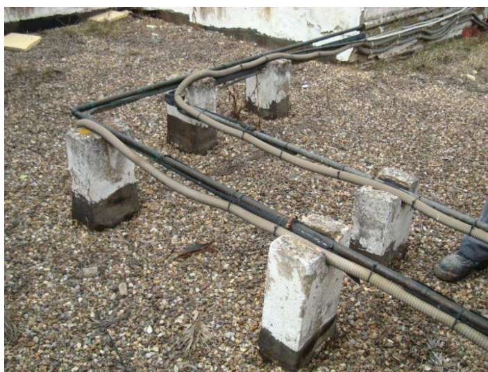
Figura 2.1: Detalle fallo de aislamiento
