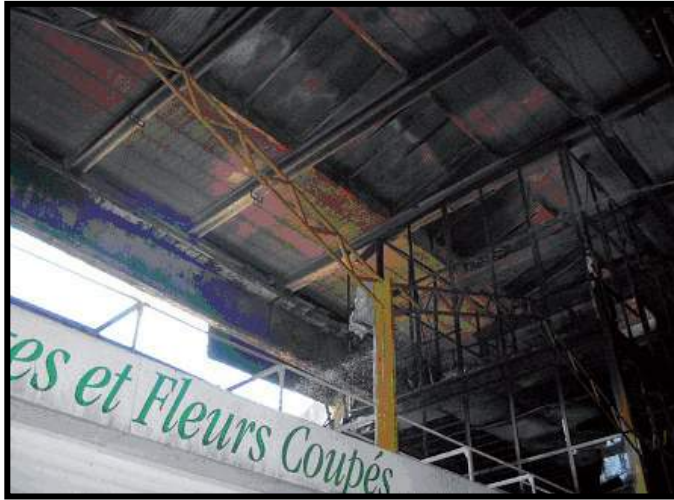
Fig. 5.16 El interior destruido del almacén, que fue reparado rápidamente
