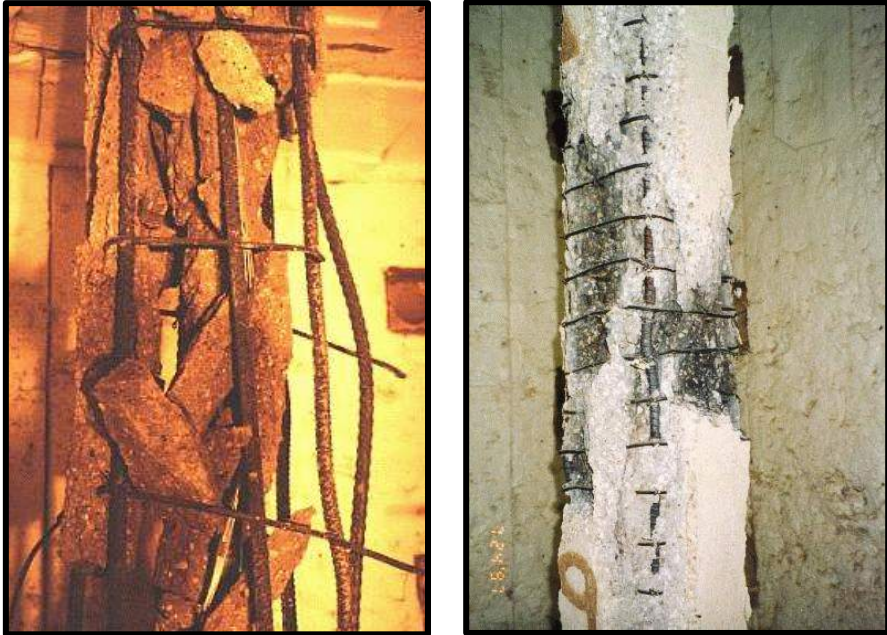
Fig. 6.5 Pilar de HAR con una disposición normal de estribos (izq.) y otro con una disposición modificada (dcha.)
