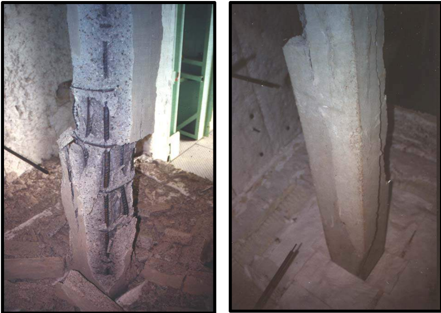
Fig. 6.3 Comparación entre el spalling de un pilar de HAR (izq.) y un pilar de HC (dcha.)
