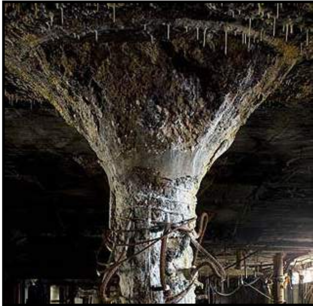
Fig. 5.20 "Fall of" de una estructura de hormigón tras un incendio
