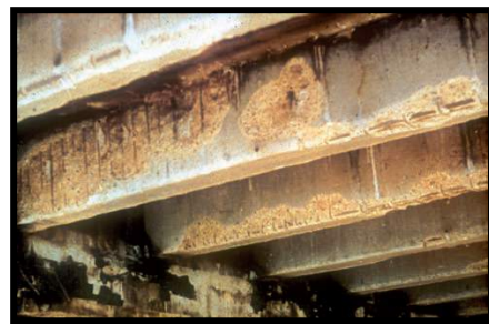
Fig. 5.3 Ejemplo de elementos de hormigón mostrando desconchados
