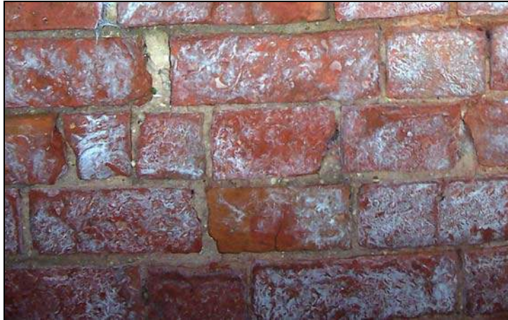
Figura 1.4.: Eflorescencias en fábrica de ladrillo
