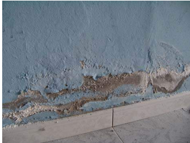
Figura 1.1.: Humedad por capilaridad
