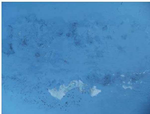
Figura 1.2.: Humedad de condensación
