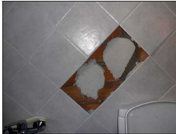
Figura 1.3.: Desprendimiento de alicatado
