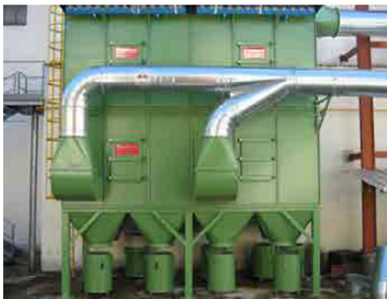
Ilustración 10. Detalle filtro de mangas.
