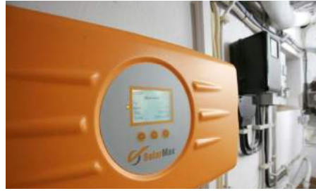
Inversor con pantalla; instalado en un sótano [imagen: Sputnik]
