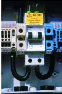
Interruptor principal CC en la caja de conexión
