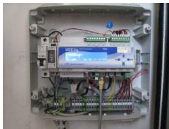
Registrador de datos (datalogger)
